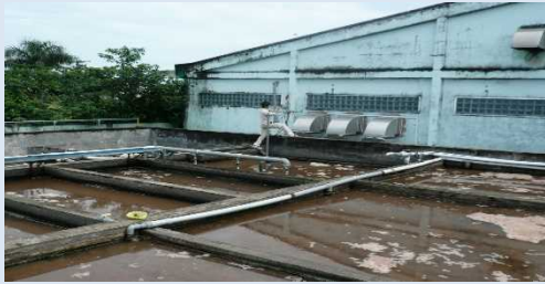
(実証試験の例: 日本の自動酸素供給装置をベトナムの食品加工排水処理施設に設置)
