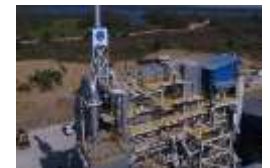
廃棄物発電施設
