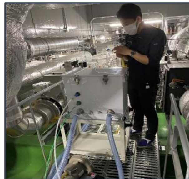
除染ガス循環装置の設置
