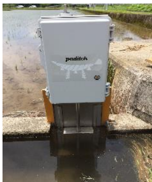
自動開閉水門
