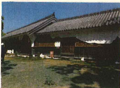
重要文化財の櫓の損傷例
