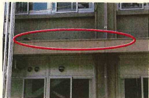
立入禁止校舎壁面のクラック
