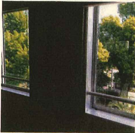
教室（理科室）の損傷例
